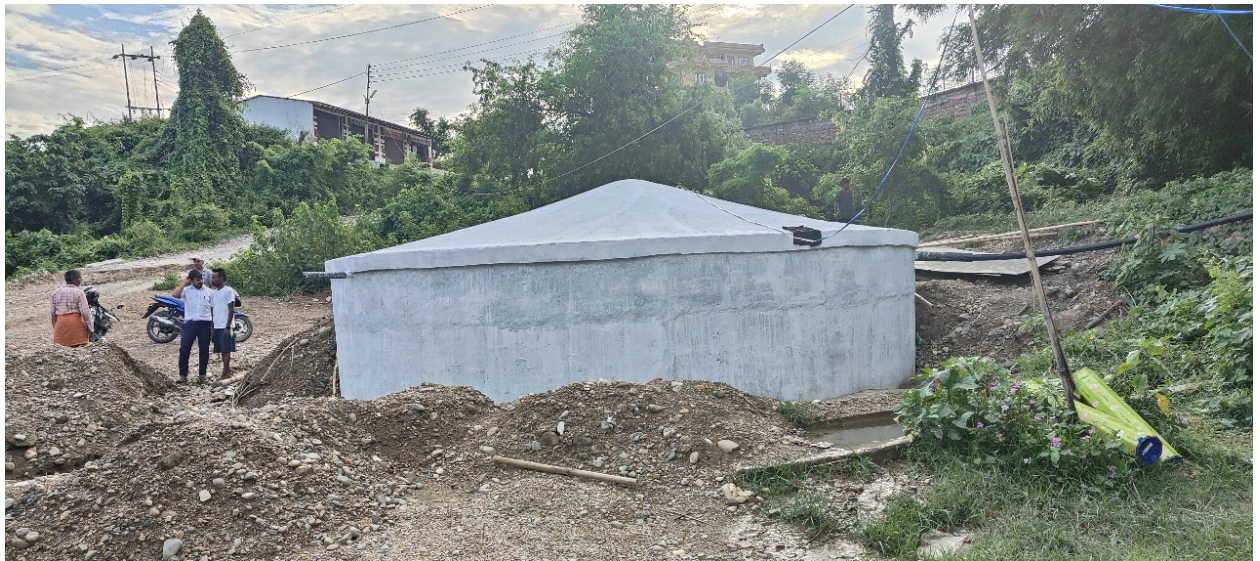
वडा नं ११ स्थित खयरमारामा १ लाख लिटरको खानेपानी ट्याङ्की
